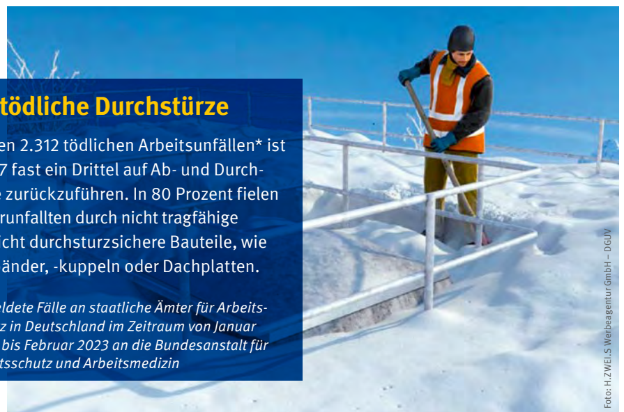
Eine dauerhafte Umwehrgung sorgt dafür, dass eine Lichtkuppel auch bei Winterwetter nicht versehentlich betreten wird
